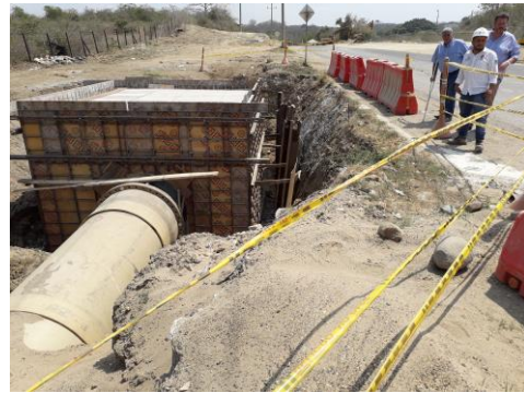
Foto 2: Redes de impulsión de la PTAP
