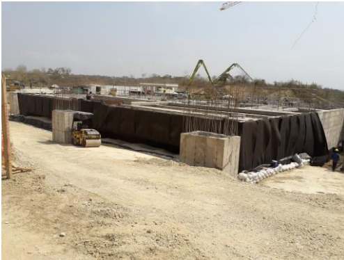
Foto 1: Módulo de la PTAP
